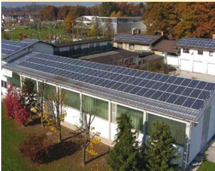
Sončna elektrarna Trata, postavljena na strehi nadzorništva in RTP Elektra Gorenjska v Škofji Loki
